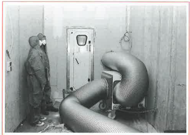
Abb. 6: Unterdruckanlage und 1-Personenschleuse
