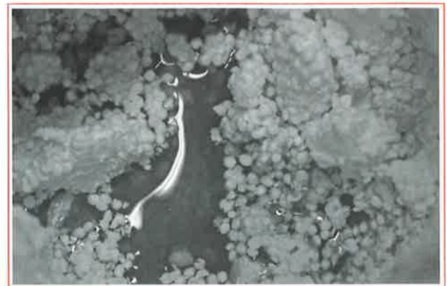
Abb. 12: Stehendes Wasser auf der Schweißbahnabdichtung unterhalb der Estrichdämmschicht in einer Restaurantküche aufgrund eines Abdichtungsfehlers
