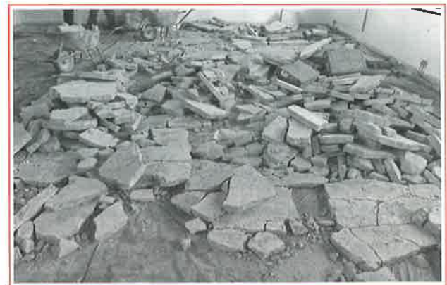
Abb. 13: Estrichabbruch oberhalb der mit Schimmel befallenen Estrichdämmschicht in einem Schul-Neubau nach einem Wasserschaden vor der Abnahme.
