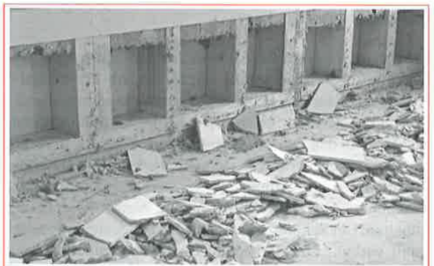
Abb. 8: Abbruch der mit Schimmel befallenen Gipsplatten einer durchlässigen Außenwand
