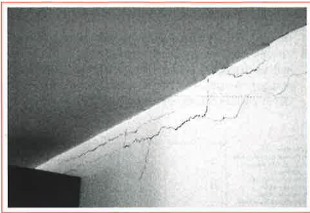
Abb. 8: Risse im Anschluss von Kelleraußenwand an die Geschosdecke im Ergebnis von ungleichen Setzungen
