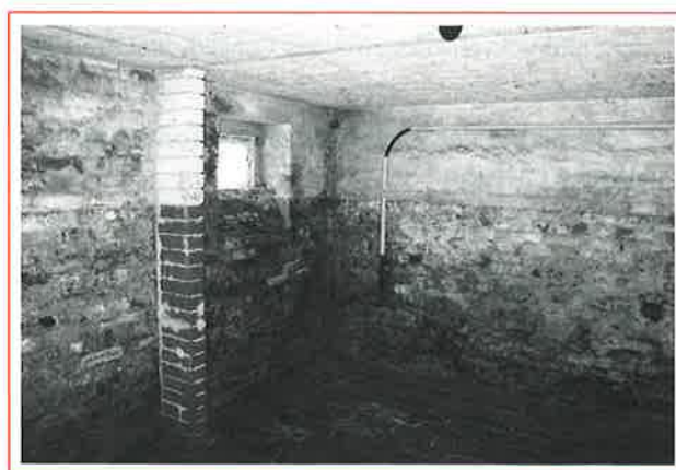
Abb. 7: Keller eines typischen Einfamilienhauses aus der Bauzeit um 1930: deutlich zu sehen ist die Durchfeuchtung der Außenwände auf Grund fehlender vertikaler Außenabdichtung. Die Horizontalabdichtung in Höhe des Kellerfensters funktioniert noch gut, zu erkennen an der trockenen Außenwand oberhalb dieser Abdichtung.
