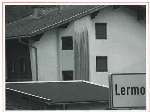
Abb. 5: Auswirkungen von unzureichendem konstruktiven Schutz
