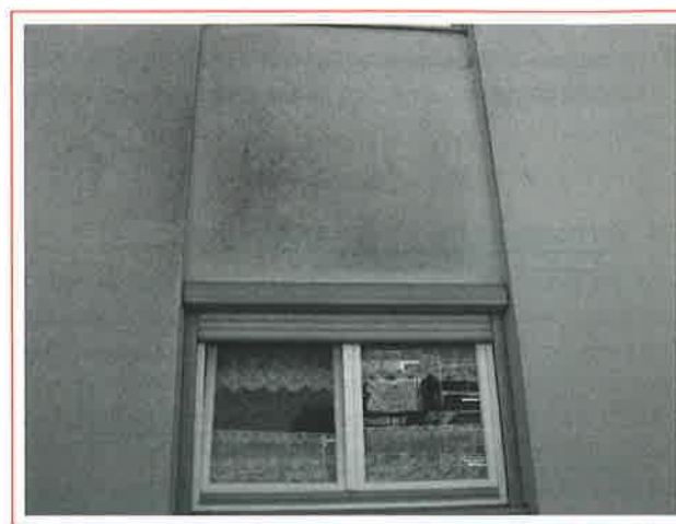
Abb. 7: Mikrobieller Befall durch nicht angepasstes Lüftungsverhalten
