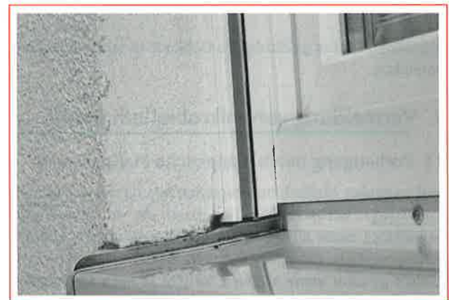
Abb. 4: Mikrobieller Befall durch nicht fachgerechte Bauteilanschlüsse
