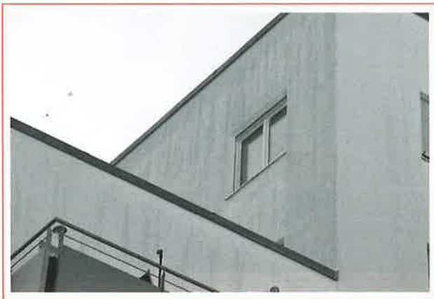
Abb. 2: Algenbefall durch unzureichenden konstruktiven Schutz
